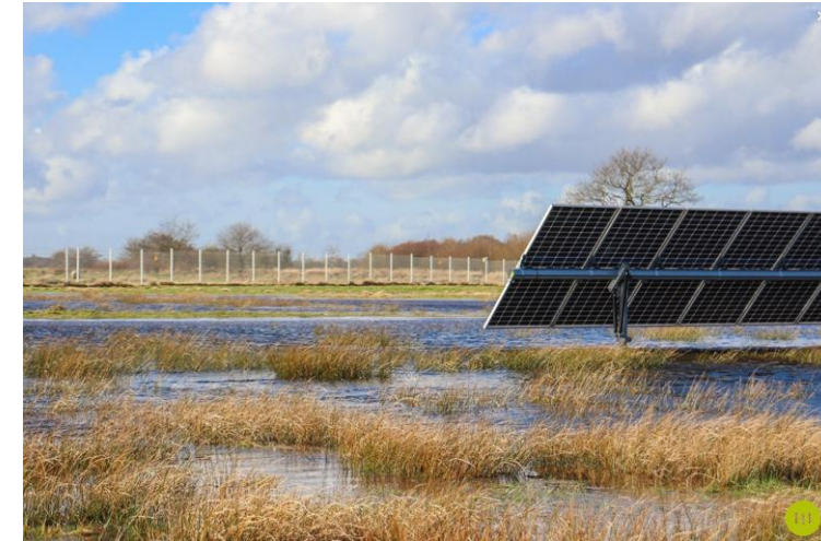
Foto von der Wattmanufactur GmbH & Co. KG (2025): Moor-PV-Pilotanlage in Lottorf, Schleswig-Holstein
